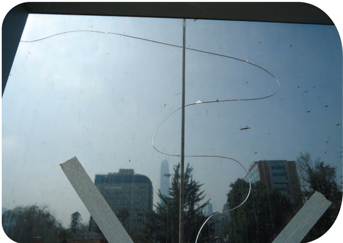
Fractura por estrés térmico.
